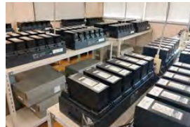
ドローンのバッテリー充電施設
