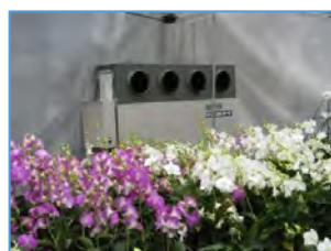
安定的採熱と ヒートポンプ利活用
