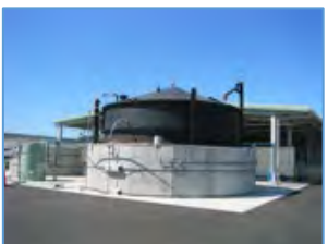
バイオガス発電
